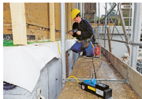
8 S'il n'y a pas d'ensemble d'appareillage de chantier à disposition, il faut brancher des disjoncteurs différentiels (DDR) mobiles.
