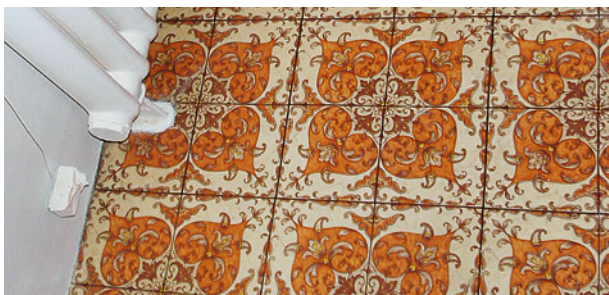
Typisches Muster eines mehrschichtigen asbesthaltigen Bodenbelags
