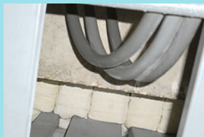
Brandabschottung mit Asbestkissen
