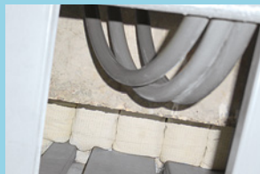
Brandabschottung mit Asbestkissen
