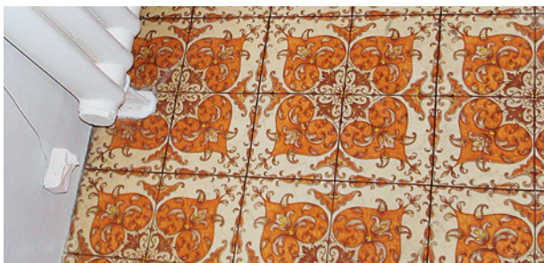
Typisches Muster eines mehrschichtigen asbesthaltigen Bodenbelags
