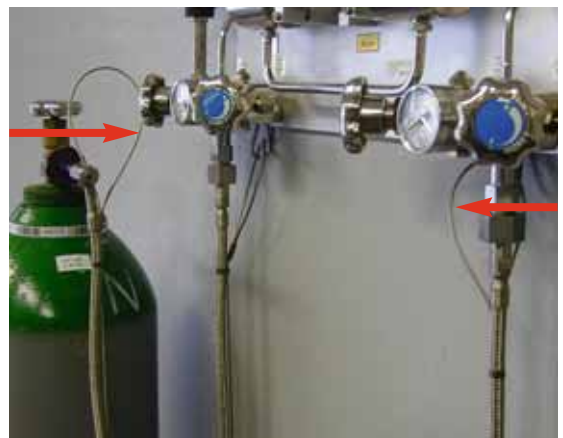
Figura 12: cavo di sicurezza
