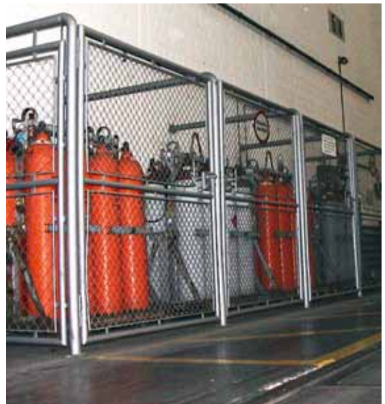
Figura 21: bombole di gas collegate in un capannone
