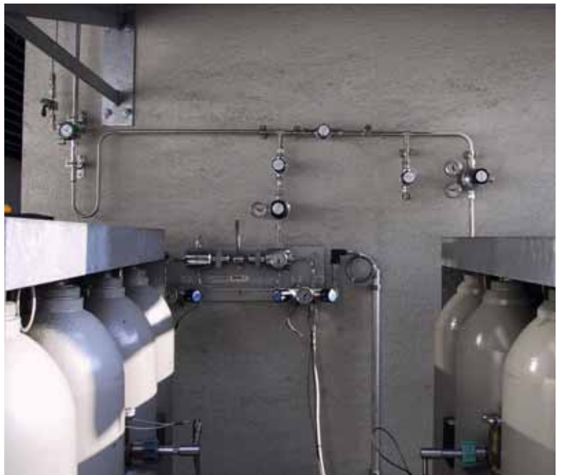
Figura 5: batterie di bombole
