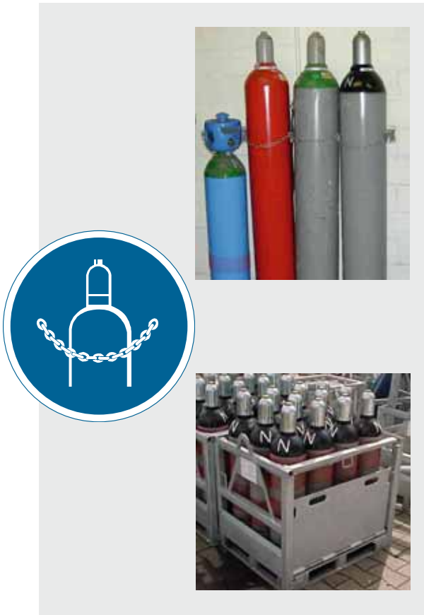
Figura 16: bombole di gas assicurate contro la caduta
