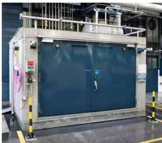
Figura 6: contenimento per gas con elevato potenziale di pericolo
