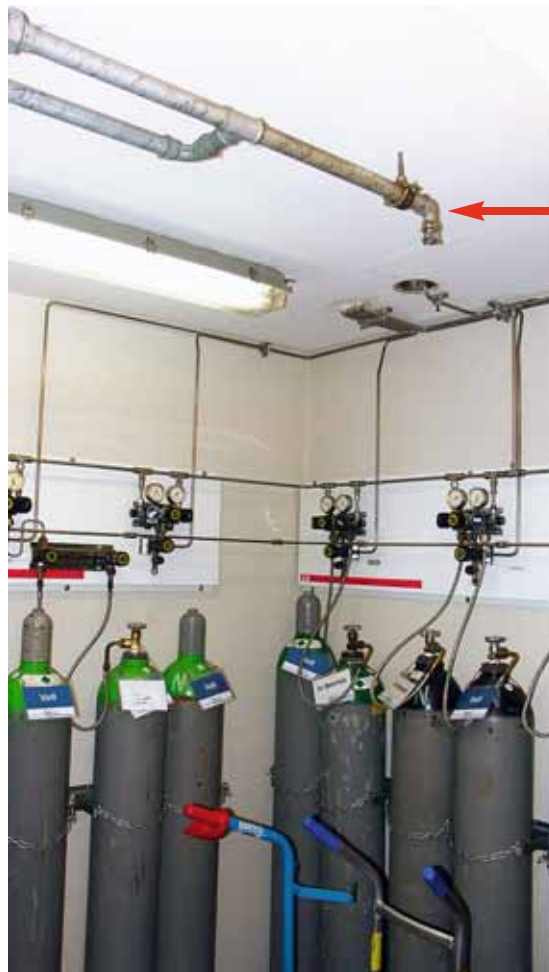
Figura 8: impianto a diluvio
