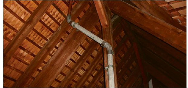
Tubazione di scarico aria
