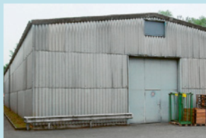
Lastre ondulate contenenti amianto
