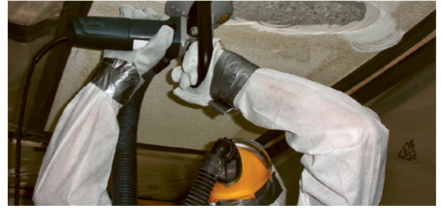
Rimozione solo da parte di ditte specializzate in bonifiche da amianto riconosciute
