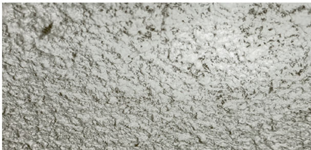
Intonaco fonoassorbente contenente amianto
