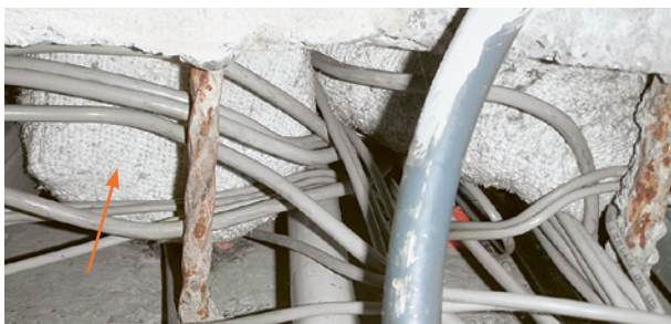
Barriere antifiamma contenenti amianto
