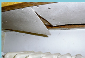
Pannelli leggeri contenenti amianto
