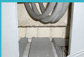
Sigillatura antincendio con cuscini di amianto
