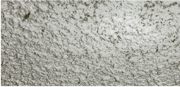
Intonaco fonoassorbente contenente amianto
