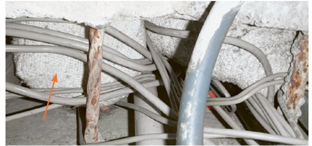
Barriere antifiamma contenenti amianto
