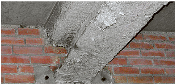
Amianto spruzzato su travi di acciaio
