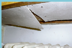
Pannelli leggeri contenenti amianto
