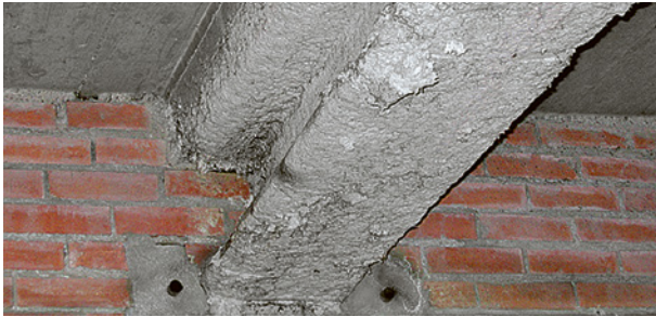
Amianto spruzzato su travi di acciaio
