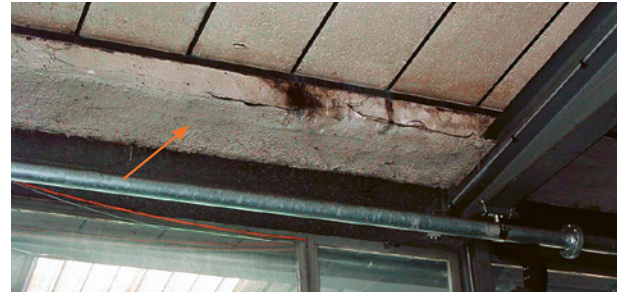
Isolamenti di amianto spruzzato sulla copertura
