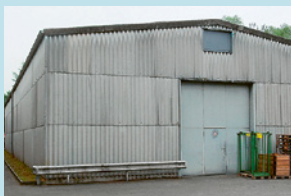
Lastre ondulate contenenti amianto
