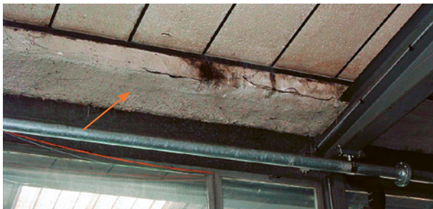
Isolamenti di amianto spruzzato sulla copertura
