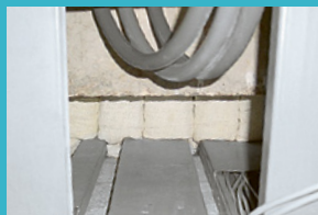
Sigillatura antincendio con cuscini di amianto
