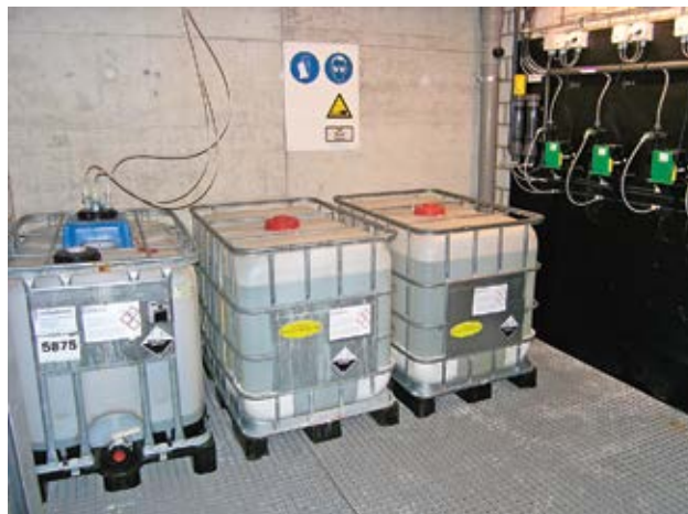
Figura 3 Vista del locale separato per il dosaggio di acido. Il pavimento è strutturato come una vasca di raccolta; nell'angolo, canale di scarico per la ventilazione artificiale del locale.
