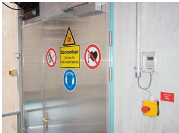
Figura 2 Pulsante di arresto d'emergenza fuori dal locale di installazione del generatore di ozono
