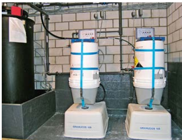
Figura 1 Stazione di dosaggio per ipoclorito di calcio. In questo modo è possibile evitare il deposito e l'impiego di cloro in recipienti a pressione.
