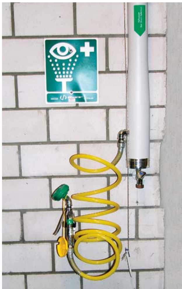
Figura 4 Attrezzature di primo soccorso nel locale degli acidi.
