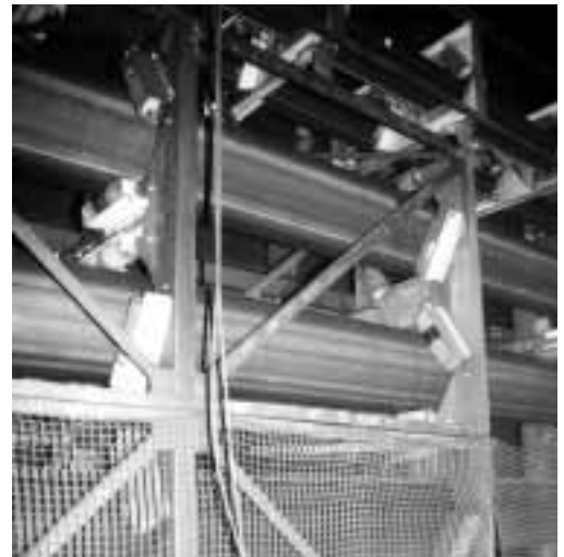
Figura 1: impianto di trasporto a nastro tubolare per lo sgombero del materiale di scavo. I nastri trasportatori sono spesso più idonei dei dumper.
