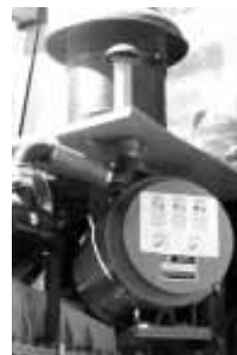
Figura 4: sistema di filtri di aspirazione. Per mantenere efficienti i filtri occorre adottare misure organizzative.
