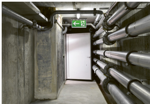
29 Via di fuga correttamente contrassegnata
