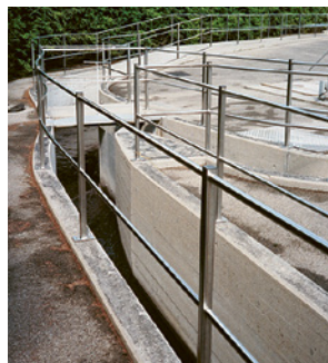
14 Parapetti posizionati lungo i lati aperti di canalizzazioni scoperte
