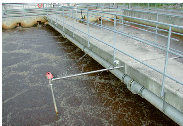
35 A mezzo di una catena è possibile spostare le sonde di misurazione verso il bordo del bacino di aerazione; in questo modo la manutenzione e la pulizia avvengono senza rischi.
