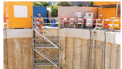
3 Tour d'escalier permettant d'accéder à des postes de travail situés en hauteur
