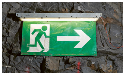
2 Signalisation des voies d'évacuation
