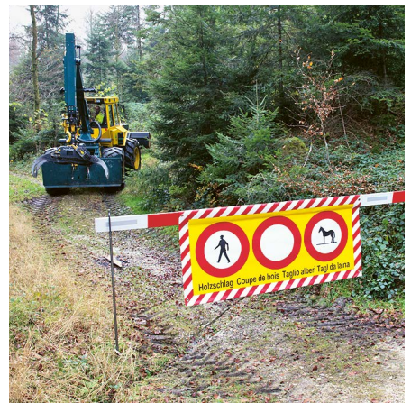
6 Barrage de sentiers, chemins forestiers et ruraux
