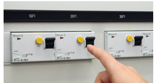
Bild 20: Fehlerstromschutzschaltungen sind in feuchten und nassen Räumen zwingend vorgeschrieben.
