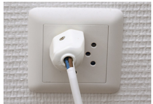
Bild 22: Defekte Elektrokabel umgehend ersetzen.
