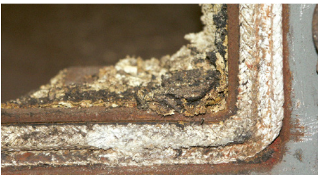
Fig. 10 Attention: nattes en amiante et cordons amiantés utilisés comme joints de portes sur les installations de chauffage.
