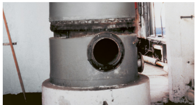
Fig. 11 Les matériaux amiantés servant à l'isolation des chaudières sont souvent recouverts, par ex. par des tôles métalliques.
