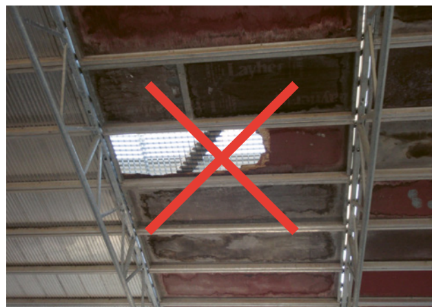
Figura 1 La presenza di macchie nere estese indica un principio di putrefazione. Il piano deve essere controllato.
