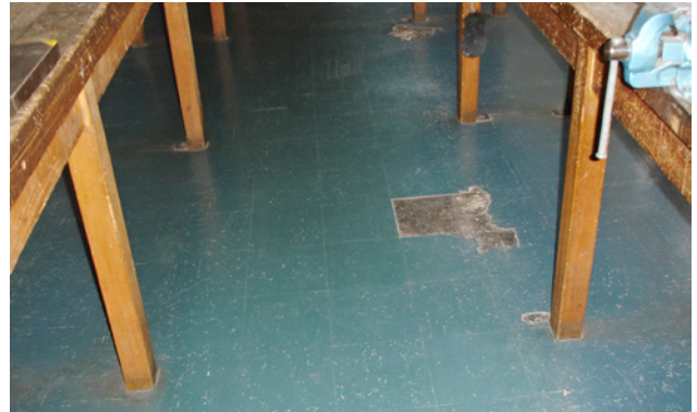
1 Rivestimenti monostrato floorflex. In questo caso l'amianto è inglobato in una matrice compatta.
