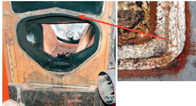
Cordon amianté d'une chaudière
