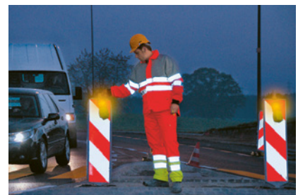
3 Illuminazione efficace del posto di lavoro
