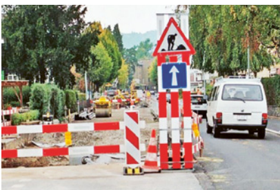
1 Il cantiere deve essere segnalato in modo permanente.
