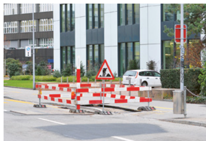
2 Apporre la segnaletica anche per lavori di breve durata.
