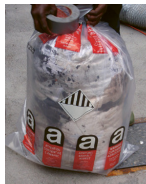
6 Sac en plastique avec marquage «Amiante»
