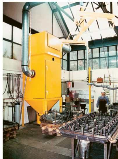
Figura 38 Impianto centrale di depolverizzazione per fumi di saldatura e polvere di smerigliatura
