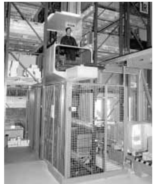
Figure 2: transtockeur à commande manuelle. L'accès au poste de l'opérateur et la zone de (dé)chargement de la marchandise sont sécurisés.
