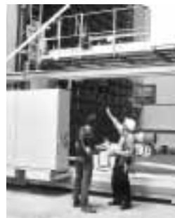
Figure 3: la planification correcte de la procédure d'élimination des dysfonctionnements constitue un élément de sécurité important pour ces activités à risques élevés.
