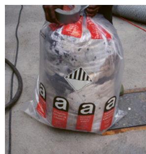
6 Sacco di plastica con la dicitura «Amianto»
