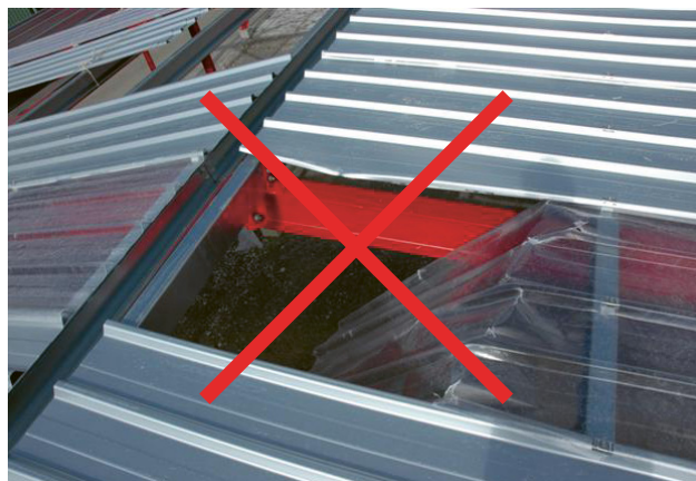
3 Bisogna evitare le cadute per sfondamento di una presa di luce.
