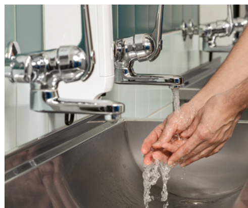
5 Il cantiere deve disporre di un numero sufficiente di lavandini.
