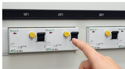
Fig. 20: I circuiti di sicurezza per correnti di guasto sono obbligatoriamente prescritti per gli ambienti umidi e bagnati.
