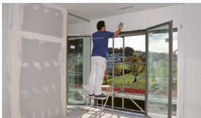
1 Il ponteggio di facciata protegge il lavoratore da un'eventuale caduta attraverso la finestra aperta.
