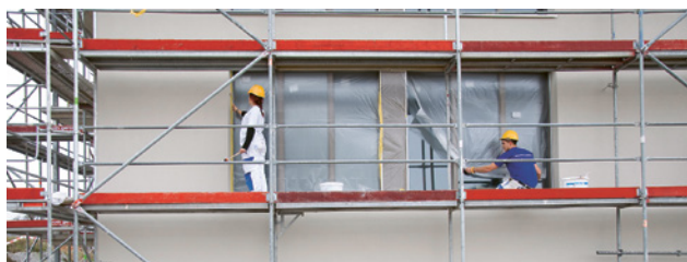
1 Ponteggio di facciata
