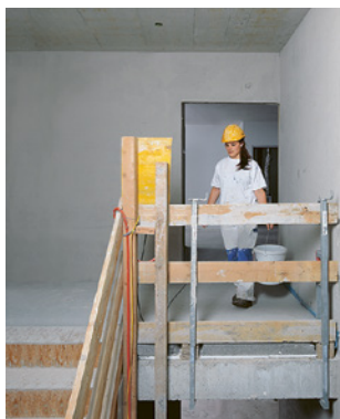
Regola 3 Mettere in sicurezza i bordi con rischio di caduta
