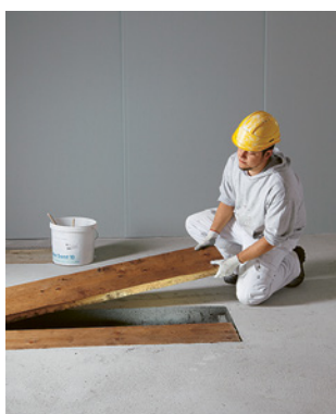
Regola 6 Mettere in sicurezza le aperture nei pavimenti
