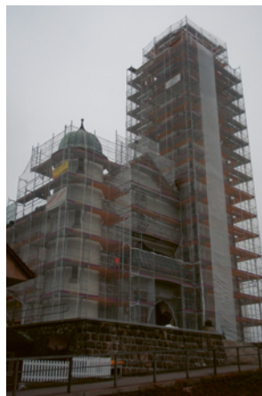
2 Échafaudage de façade conforme à la réglementation.
