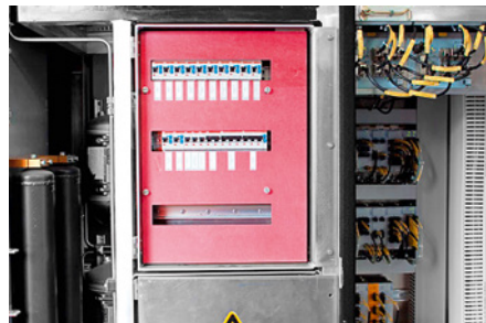
15 Una copertura isolante impedisce il contatto diretto quando l'armadietto è aperto.
