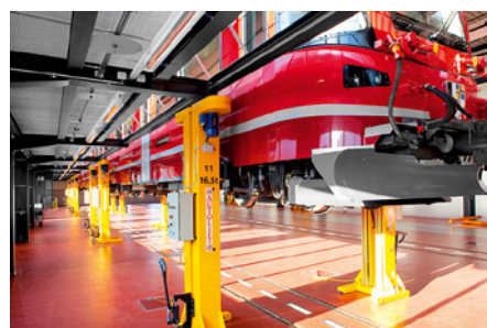
12 Impianto di sollevamento con indicazione della portata da 16,5 t.
