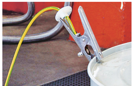
2 An einem Fassrand angebrachte Erdungsklemme
