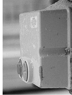
1 Als Sicherungen gegen unbeabsichtigtes Einschalten kommen zum Beispiel in Frage: Schutzkragen, versenkte Anordnung der Einschalttaste.
