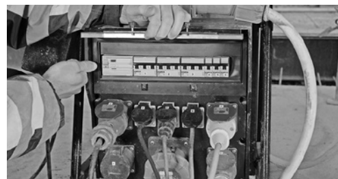
7 Quadro di prese con interruttore a corrente di difetto (salvavita FI/RCD). Testare il funzionamento dell'interruttore FI prima di avviare la macchina e rispettare le indicazioni del fabbricante.
