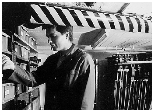
5 Tuyauterie à côté d'une étagère, rembourrée et signalée avec du caoutchouc mousse zébré jaune-noir.
