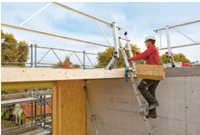
1 Die richtige Leiter am richtigen Ort – damit können Arbeitsplätze sicher erreicht werden.
