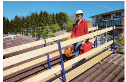
3 Nicht durchbruchssichere Dachflächen: Laufstege einsetzen.
