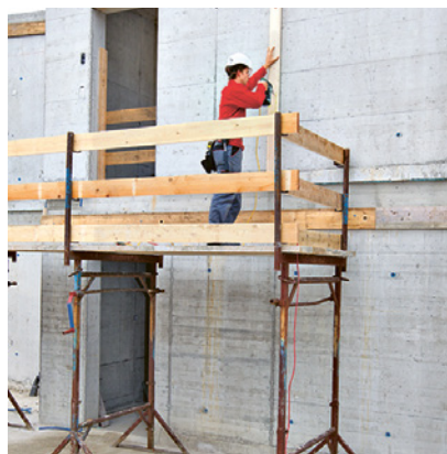
2 Bockgerüst mit korrektem Seitenschutz
