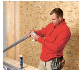
3 Arbeitsmittel nach Herstellerangaben warten.
