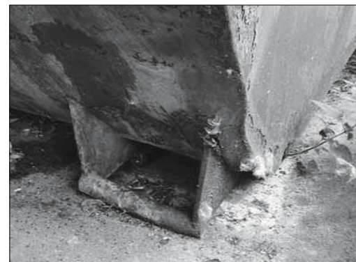
Fig. 4: gli appoggi antiribaltamento rotti devono essere sostituiti o riparati.
