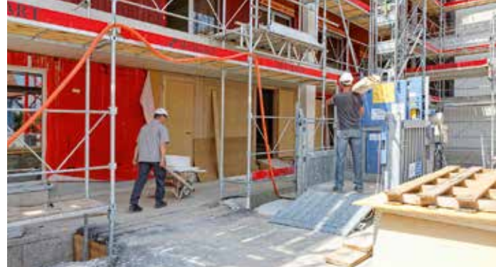
Accessi rotabili all'ascensore per facciate e all'edificio
