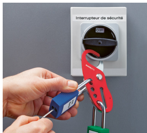
3 L'interrupteur de sécurité permet de procéder à la mise à l'arrêt complète de l'installation avant les travaux d'entretien.
