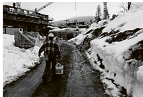
2 Une personne doit être spécialement affectée au déblaiement de la neige.
