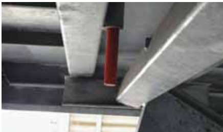
02 // Les goupilles de sécurité bloquent la barre transversale située sous la plateforme, et l'empêchent de s'abaisser.
