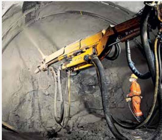
Gute Tunnelluft – ein Recht für alle.
