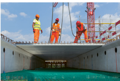
1 Zuerst Kollektivschutzmassnahmen ausschöpfen (z. B. Auffangnetze montieren).
