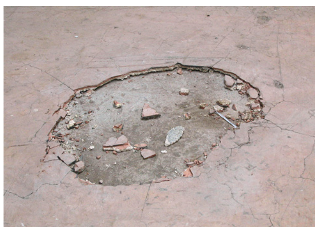
1 Steinholz-Bodenbelag – asbesthaltiger Magnesia-Estrich
