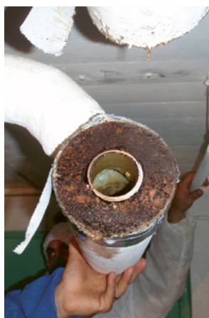
7 Tuyau coupé qui est encore emballé avec une feuille de plastique.
