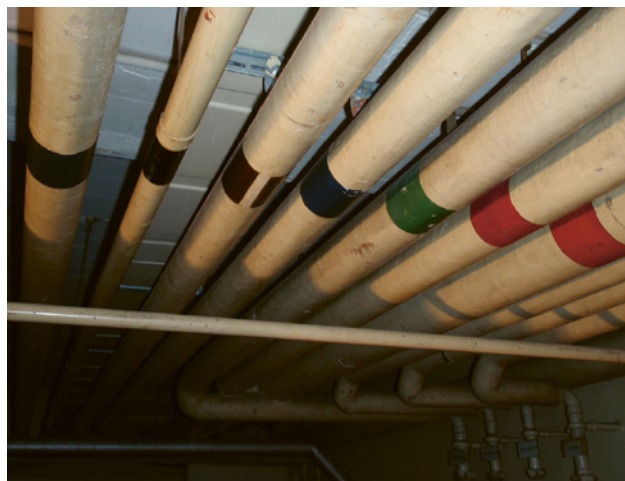
1 Isolation de tuyau composée de plâtre amianté.
