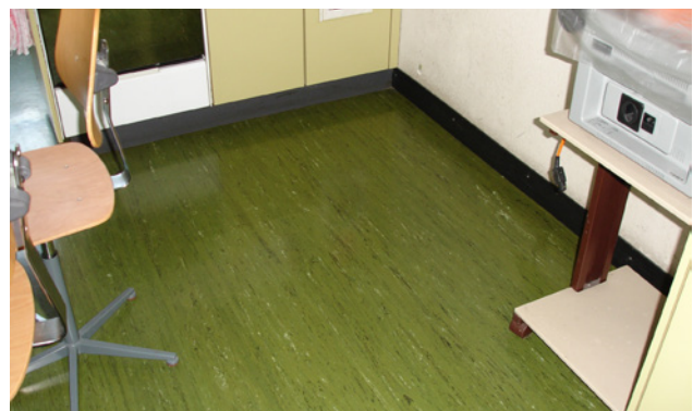
2 Ce revêtement de sol synthétique souple en lés contient également de l'amiante fortement aggloméré.
