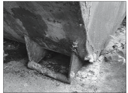
Bild 4: Angerissene, defekte Kipplager müssen ausgewechselt oder repariert werden.
