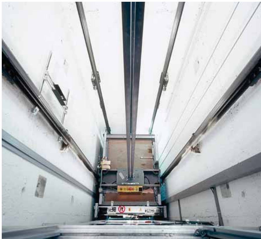
01 // Il tetto di un ascensore: si può lavorare sopra la cabina soltanto se è stata prima messa in sicurezza contro ogni movimento incontrollato (come una caduta). // Foto: Suva
