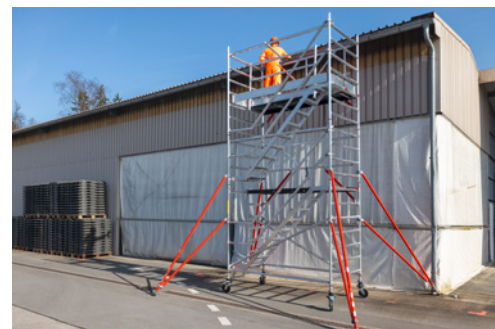
7 Zu einem regelkonformen Rollgerüst gehören: dreiteiliger korrekter Seitenschutz, tragfähige Beläge, Abstützung.
