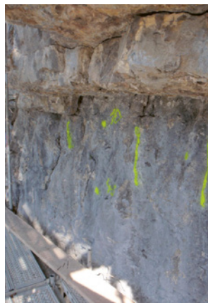
3 Lors des travaux exposés aux dangers naturels, les risques doivent être réévalués en permanence (p. ex. pans de roche risquant de tomber).
