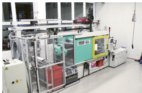
5 Enceinte de protection d'un îlot de production avec surveillance électrique des portes d'accès.
