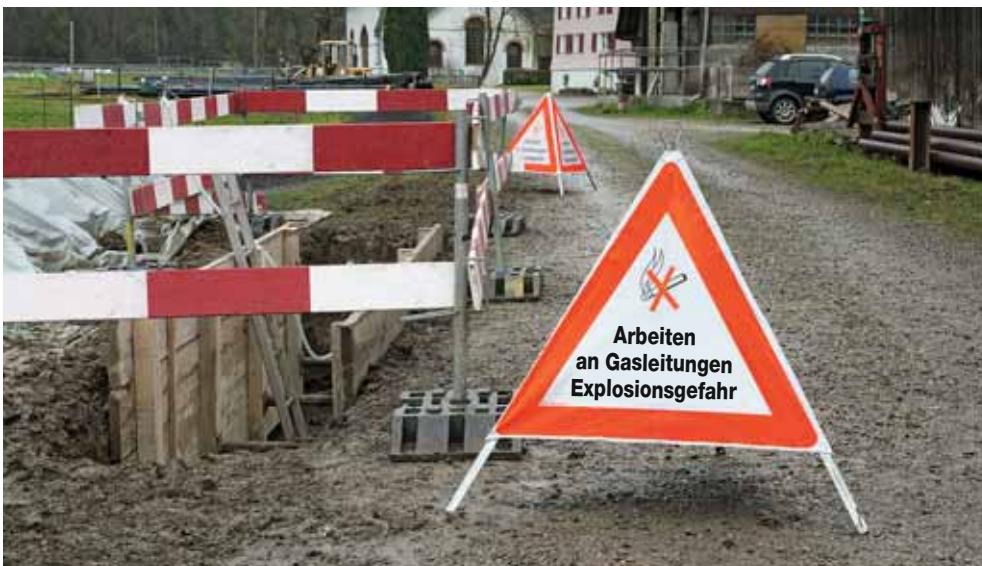
Bild 20 Abschränkung mit Gefahrenhinweis
