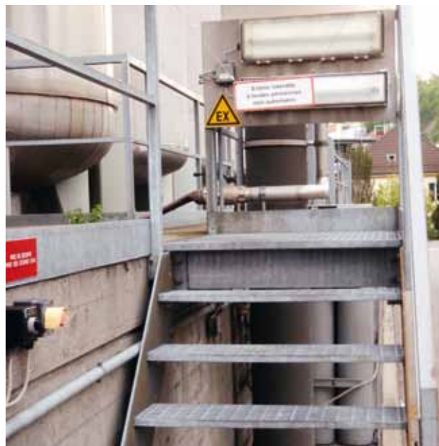
23 All'interno delle zone a rischio di esplosione è vietato introdurre fonti di innesco. Le zone devono essere contrassegnate con i cartelli «EX».
