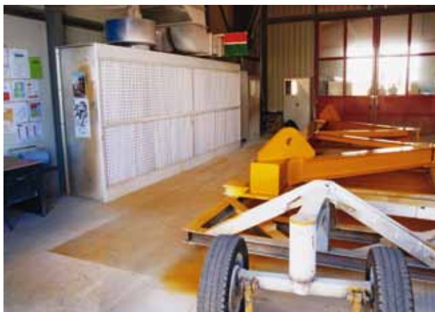
17 Parete di aspirazione che consente di eseguire occasionalmente lavori di verniciatura a spruzzo in un grande capannone senza correre alcun rischio.
