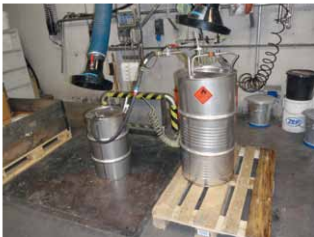
26 Messa a terra di recipienti (travasamento di solventi con sovrappressione di azoto)
