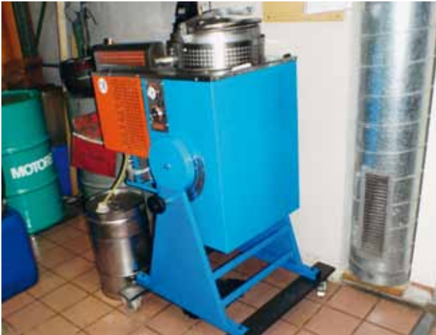
29 Impianto di distillazione per liquidi infiammabili
