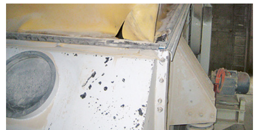
5 Leckstelle bei Einhausung
