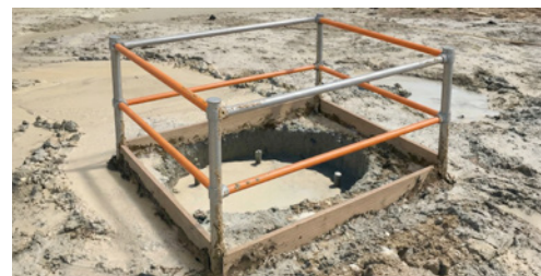
6 I fori aperti devono essere protetti con una copertura fissa e resistente oppure con una protezione laterale mobile.
