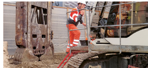
7 Salire e scendere correttamente dalle macchine è importante per prevenire gli infortuni.
