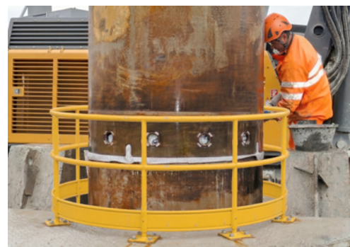
5 Mentre assembla le parti di attrezzature, il collaboratore è esposto al pericolo di caduta se, ad es. non è presente una protezione laterale.
