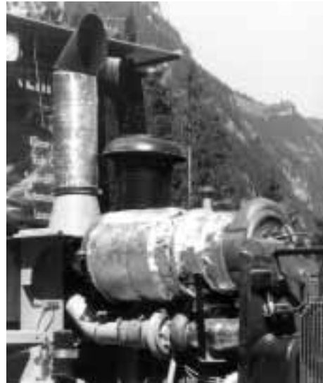
Bild 5: Gegen Hitzeabstrahlung isolierter Partikelfilter. Es ist zu verhindern, dass wegen Hitzeinflüssen Leitungen spröde werden und Aggregate (z. B. Alternator) versagen.
