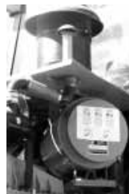
Bild 4: Ansaugluft-Filterssystem. Für den Unterhalt solcher Filter müssen organisatorische Massnahmen getroffen werden!
